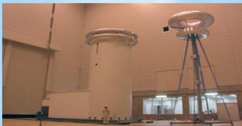
高電圧絶縁実験設備
