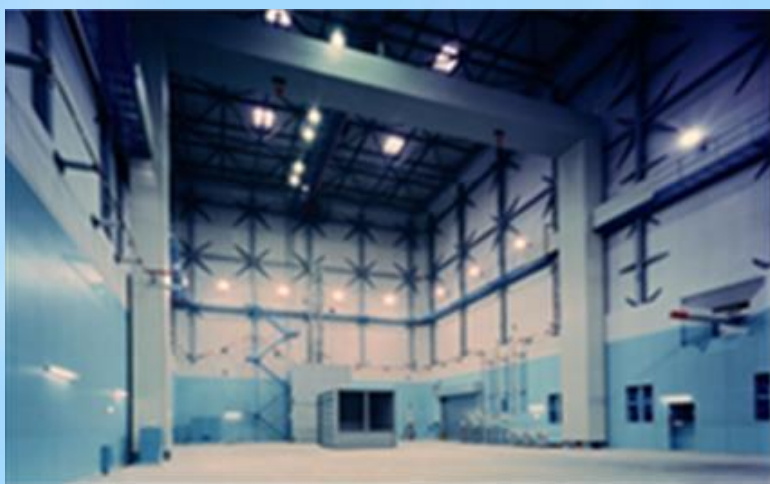
大容量電力短絡試験設備
