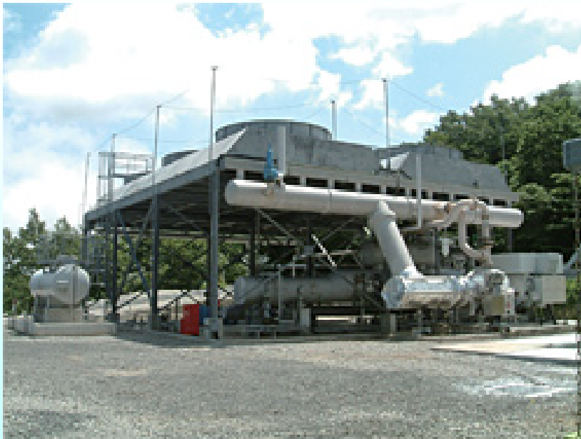
バイナリー発電設備2,000kW
