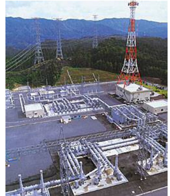
新西広島変電所
