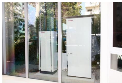
イワタニ水素ステーション芝公園に納入した1φ 700W純水素燃料電池(*)
