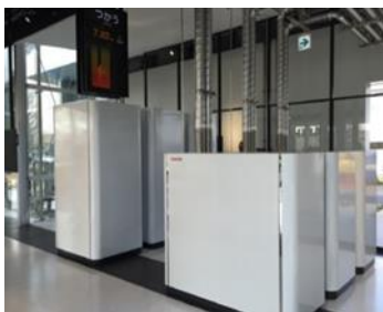
当社研究所の3φ 700W×12台=8.4kW 純水素燃料電池
